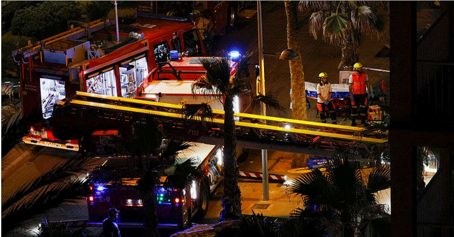
Los servicios de Emergencias trabajan en la Playa de Palma tras el derrumbe de un restaurante ubicado en una planta baja. CATI CLADERA / EFE
